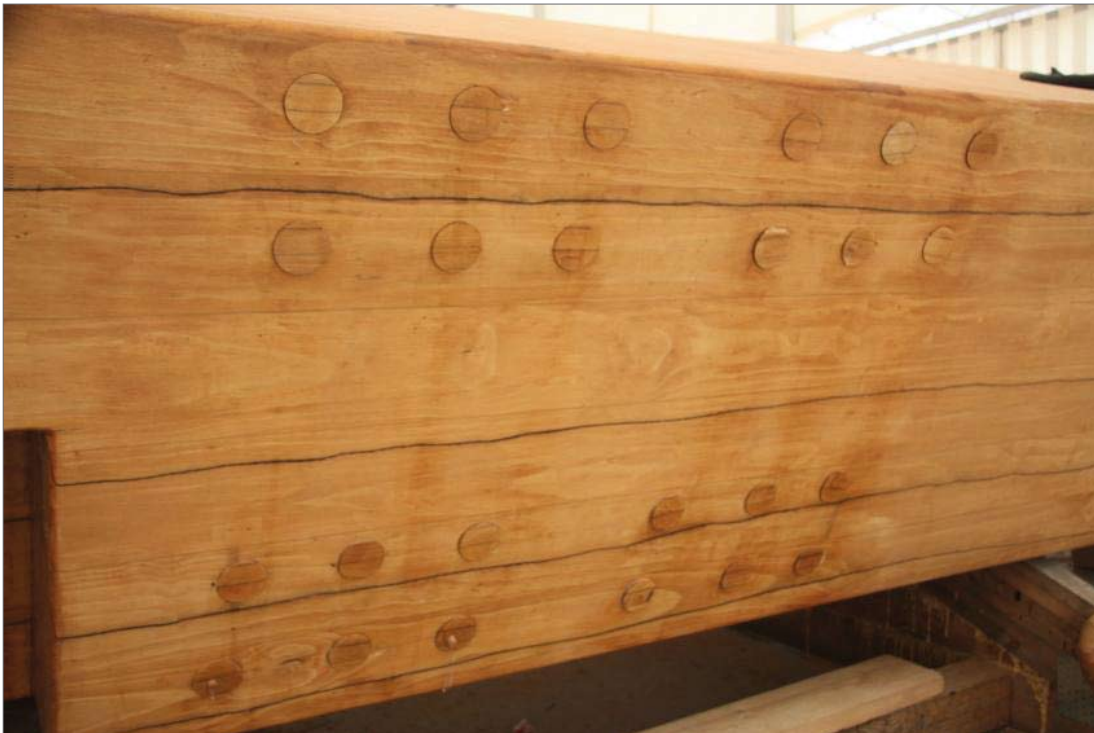
Bild 29: Bündiger Verschluss der Bohrlöcher für die Stahlstäbe im Bereich der Holzoberfläche (Fa. Schaffitzel)
