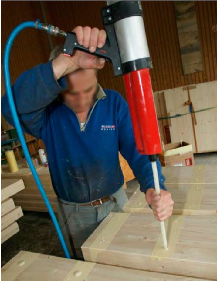
Bild 19: Einfüllen des Klebstoffes über zusätzliche Bohrlöcher, ersichtlich ist auch das Austreten des Klebstoffes aus den Bohrlöchern (Mayr-Melnhof Kaufmann Reuthe GmbH)
