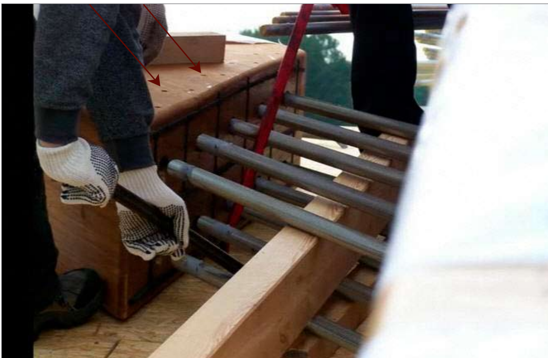
Bild 23: Entlüftungslöcher (Fa. Schaffitzel)
